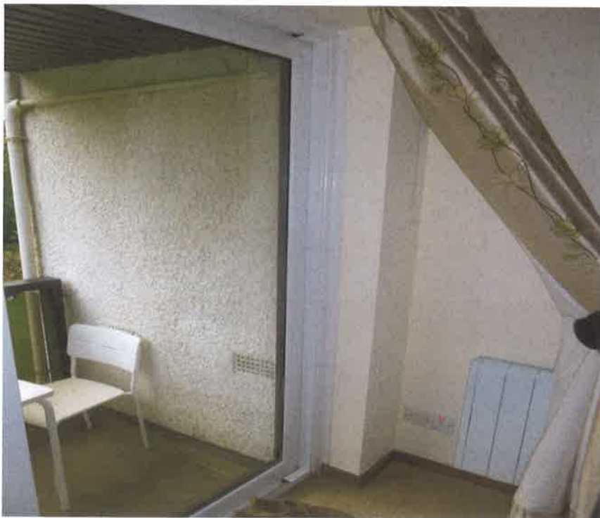
R/H side patio door – damp meter 19%
